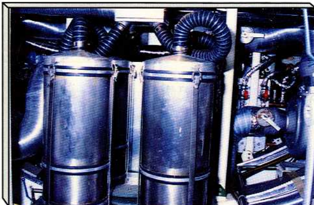
Une partie de l'installation
