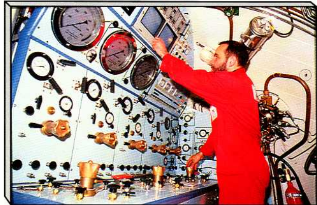
Le poste de contrôle plongeurs
