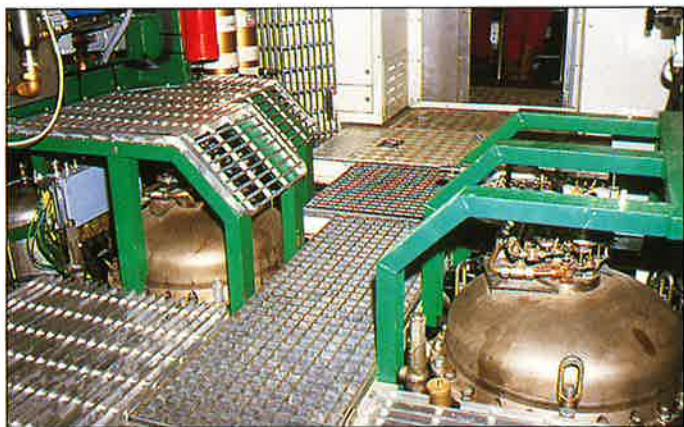
Les deux moteurs STIRLING 75 kW installés à bord du SAGA.
