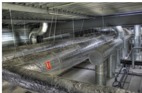
Réseaux aérauliques plénum
