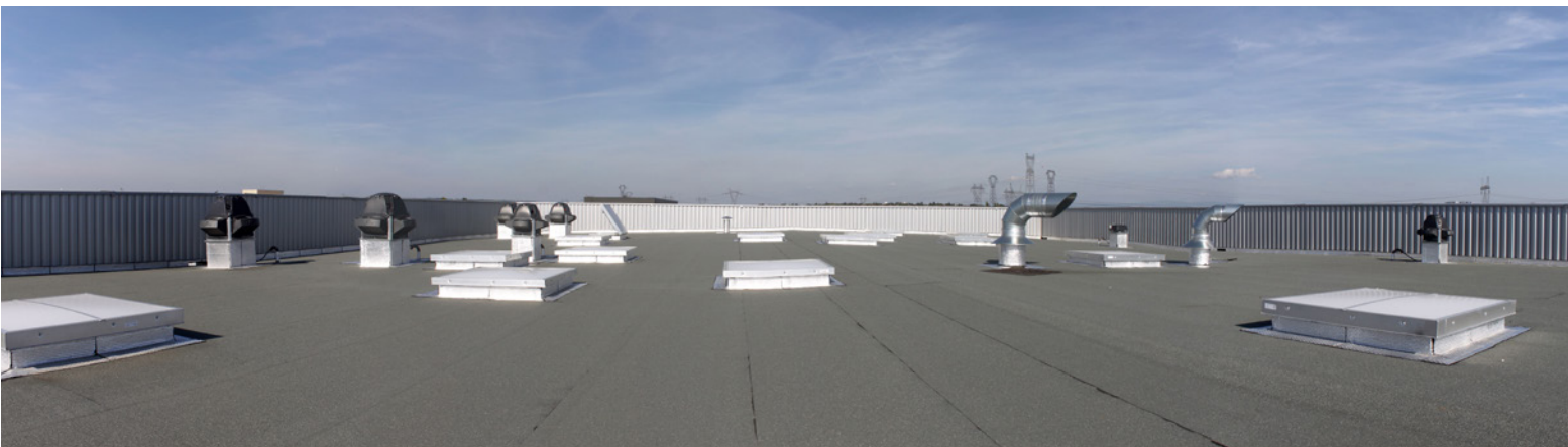
Commande PV-GV hotte et extraction de fumées
