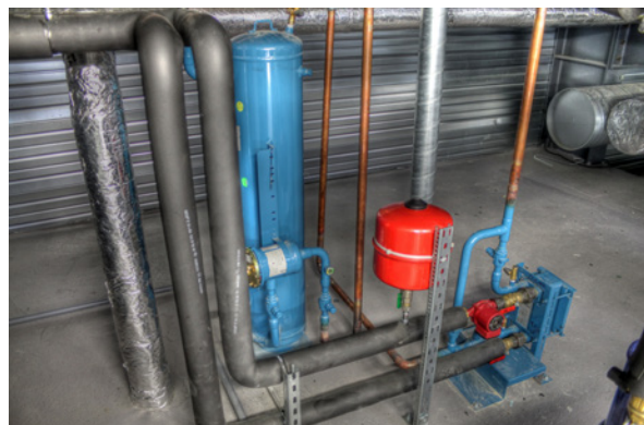
Désurchauffeur et échangeur pour préparation ECS
